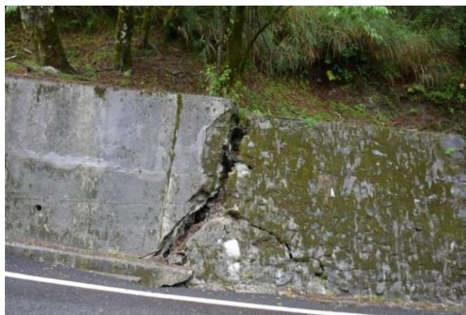
圖 14. 路旁擋土牆等結構物已遭潛移破壞，擋土牆身受向外擠壓力而傾斜裂開，呈明顯的裂縫
