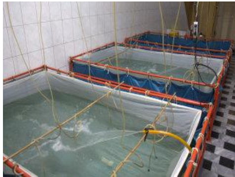
照片 2. 魚苗寮的暫時存放池
